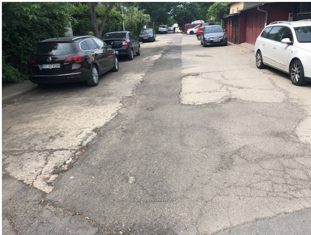
Foto Axa 8 – din strada Estacadei, adiacent Str. Bradisului, Str. Alesd Bl. N21, N23, N25
