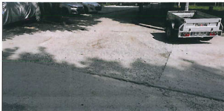
c. Defecțiunile ale complexului rutier
