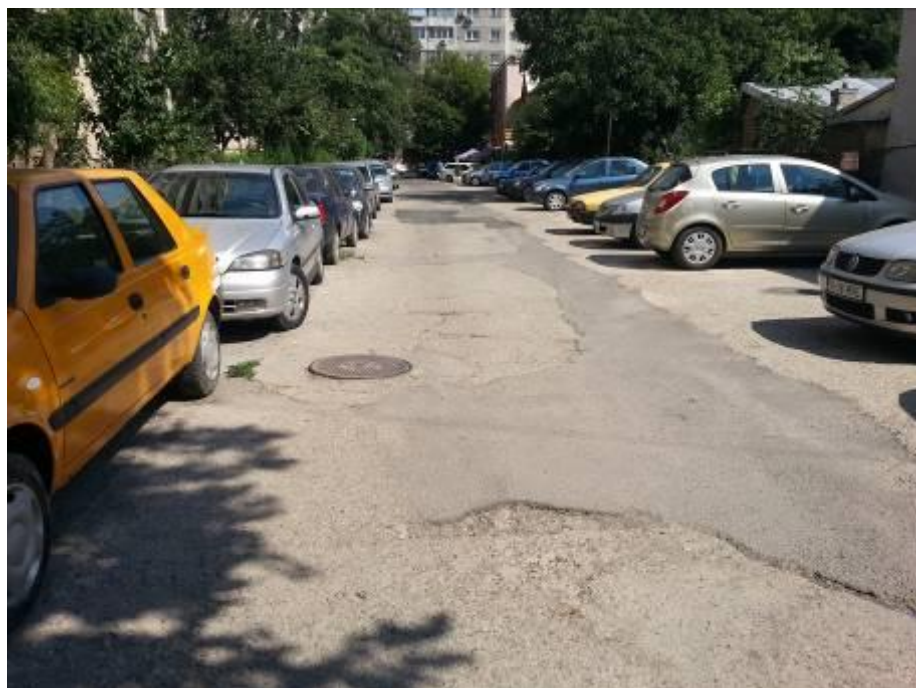
Figura 6 - Aleea Constantin Bratescu – zone degradari ale partii carosabile
