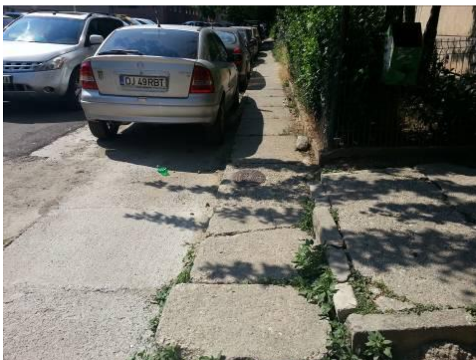
Figura 7 - Aleea Constantin Bratescu – zona cu trotuar deteriorat
