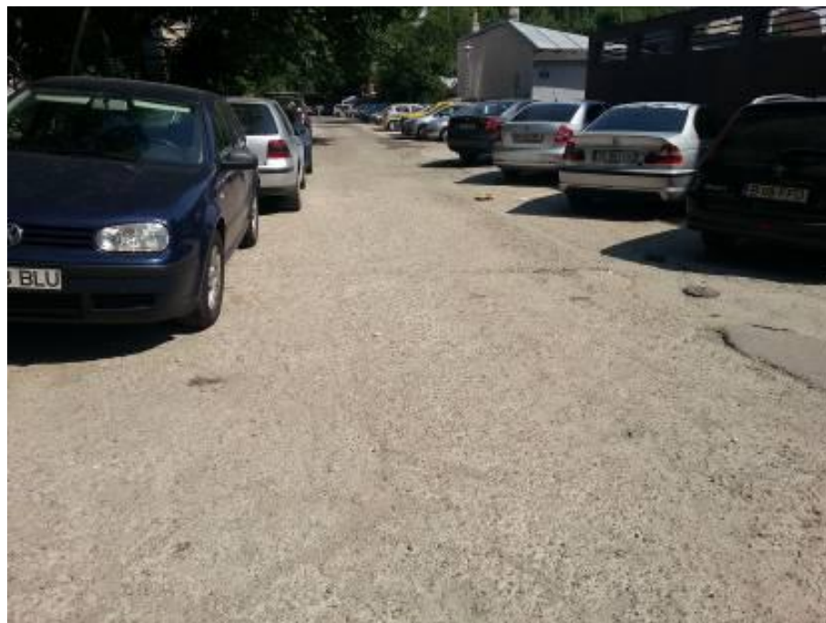
Figura 5 - Aleea Constantin Bratescu – zone cu asfalt deteriorat
