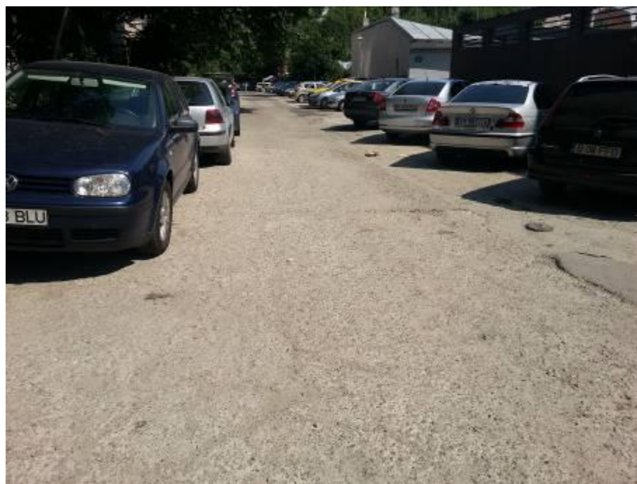
Figura 3 - Aleea Constantin Bratescu - exfolieri ale dalelor din beton de ciment
