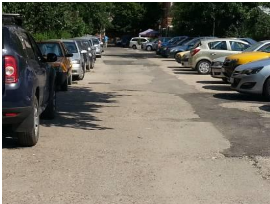
Figura 4 - Aleea Constantin Bratescu - zone cu plombe si degradari ale dalelor din beton de ciment
