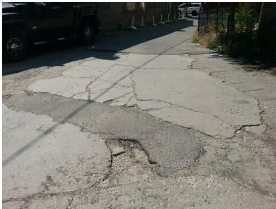
Figura 2 - Aleea Constantin Bratescu - degradari ale dalelor din beton de ciment
