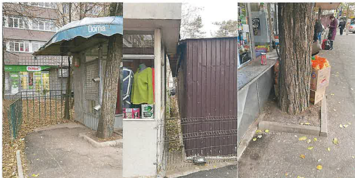
Figură 4 - Exemple de deficiențe
